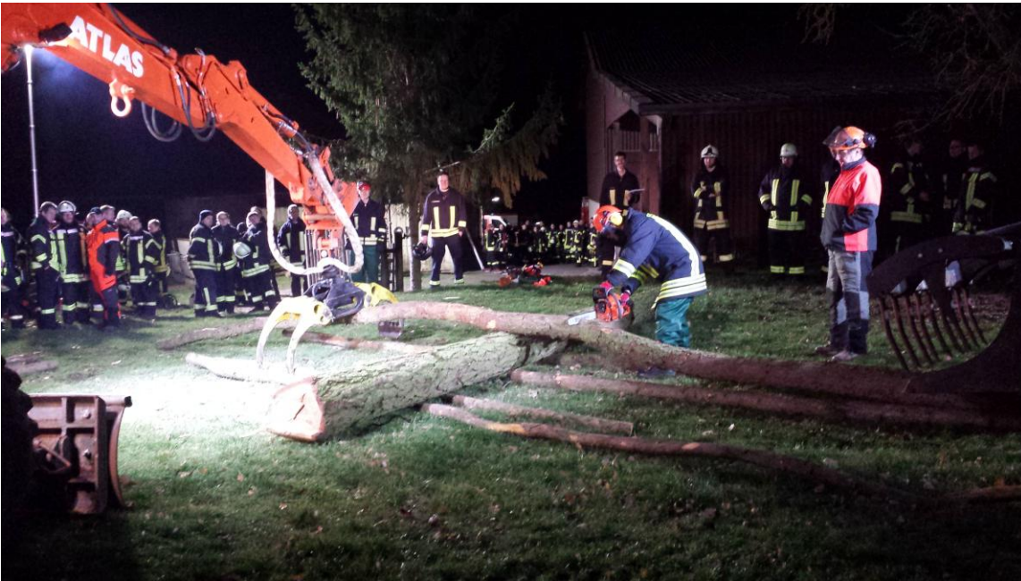
Bild: Mit Bagger und Radlader wurde der Baumstamm künstlich unter Spannung gebrachtes Holz.
